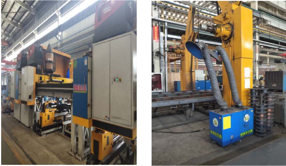
图 4-1 废气处理装置
