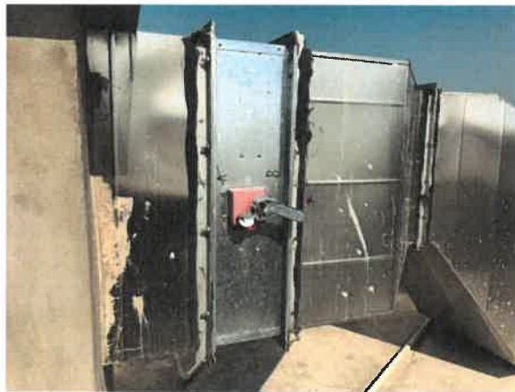
图 4-6 食堂油烟排放管道的控制阀
