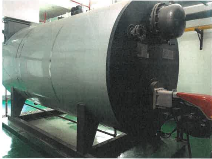
图 4-4 项目低氮冷凝燃气真空热水锅炉
